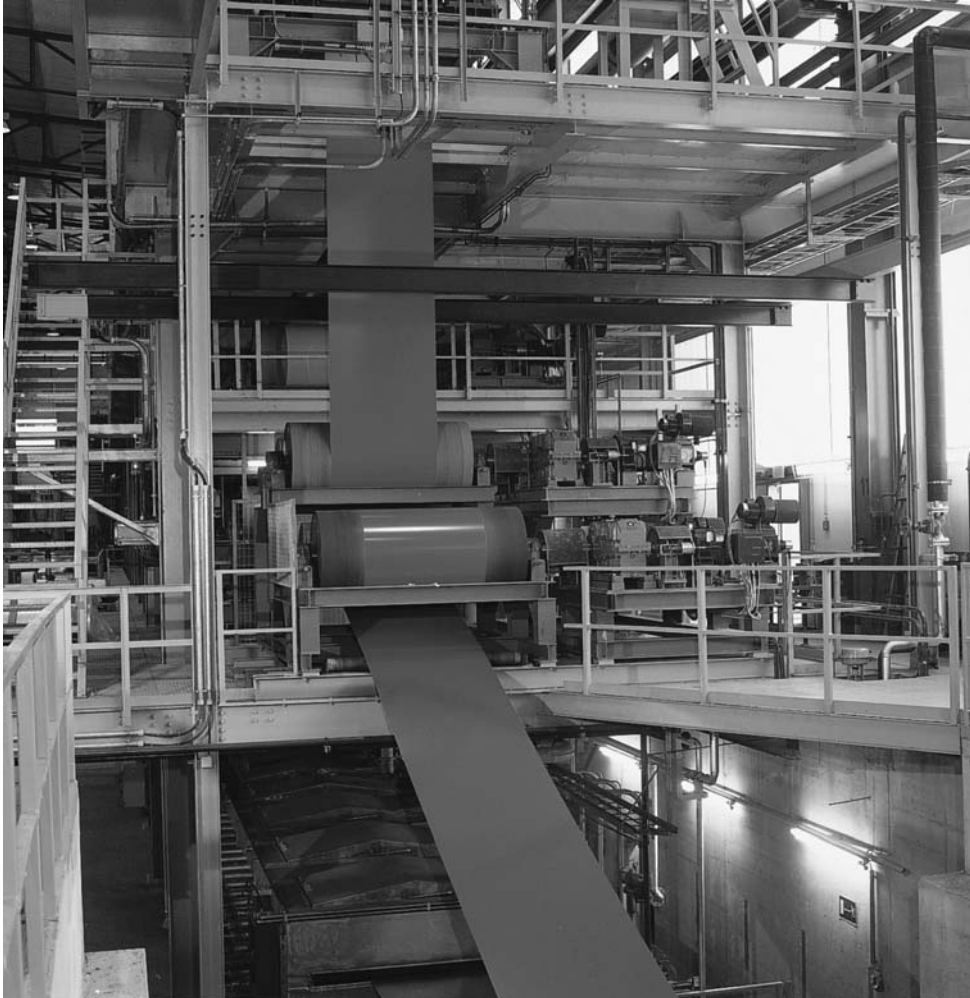
Bild 1-4 Blick auf den Auslaufteil einer Breitbandanlage
