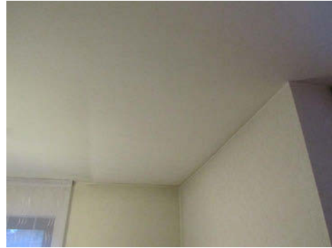
Abb. 2.1.4-8 Decke unter Dachterrasse: „grauer“ Farbton = Wärmebrücke
