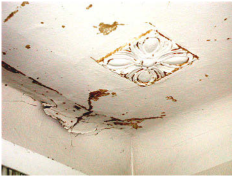
Abb. 2.1.4-1 Deckenuntersicht mit Wasserschäden
