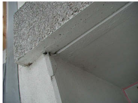
Abb. 2.2.2-2 Geringe Bauteildicke der Betonbrüstung
